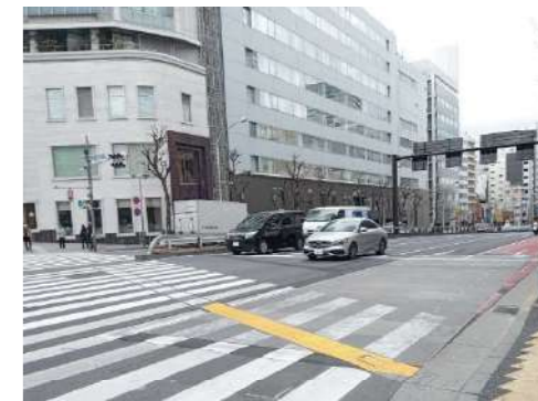
新宿区東5丁目交差点 都道305号線にて施工 ☆OLY横新型 幅4.0m 延長13.0m☆
