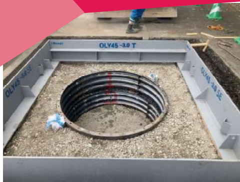
円形リフトプレート2段先行設置後、OLY45型施工 ☆OLYならスピーディなので、立坑も同時施工可能☆
